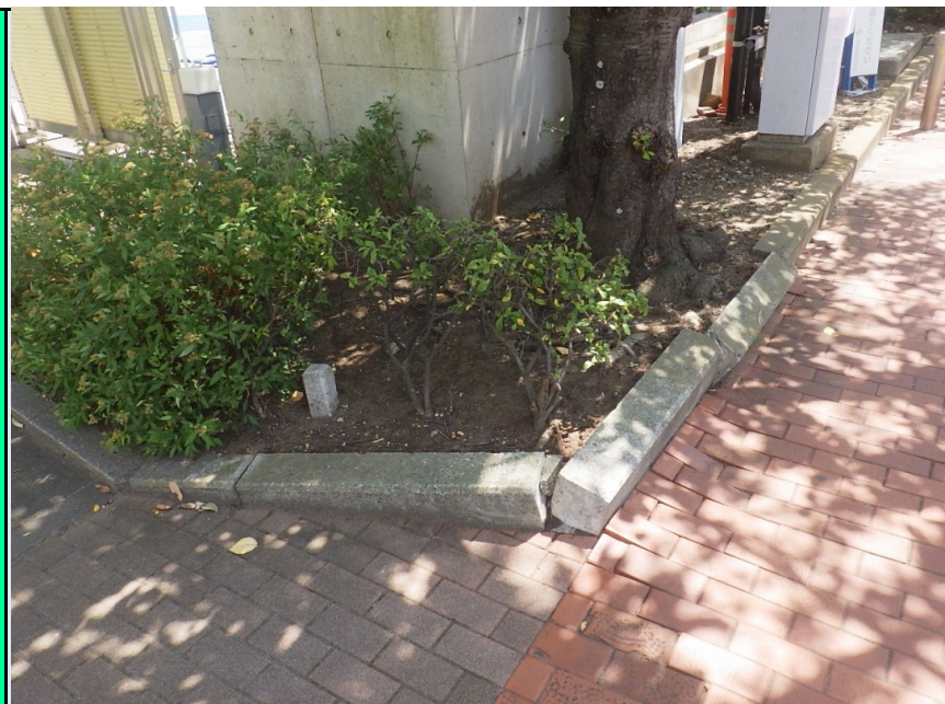
写真2 (根上がりによる縁石外れ)
